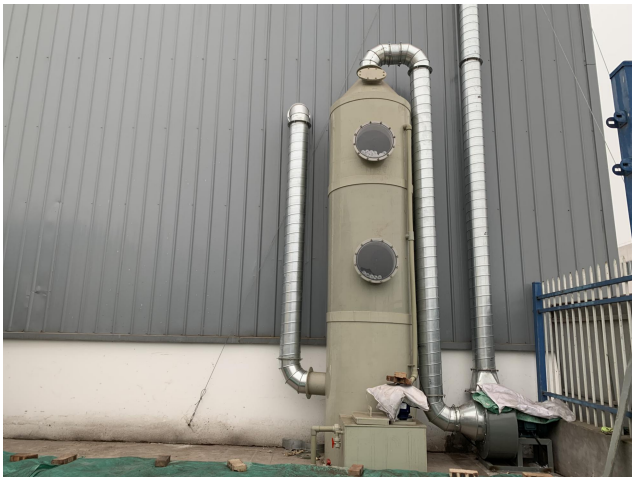
碱液喷淋塔及排气筒
