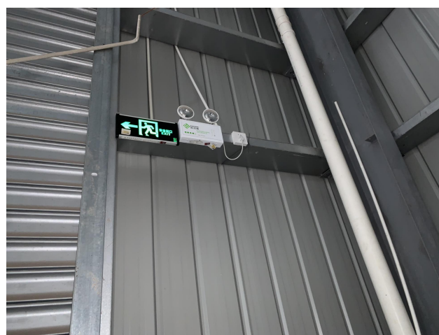
应急照明设施
