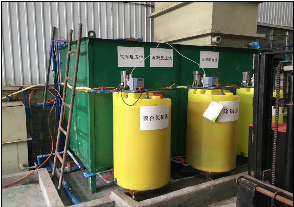
废水处理设施
