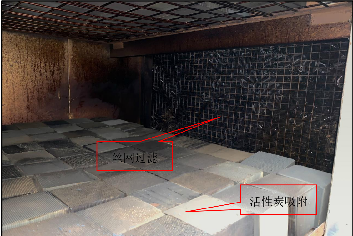
废气处理柜内部
