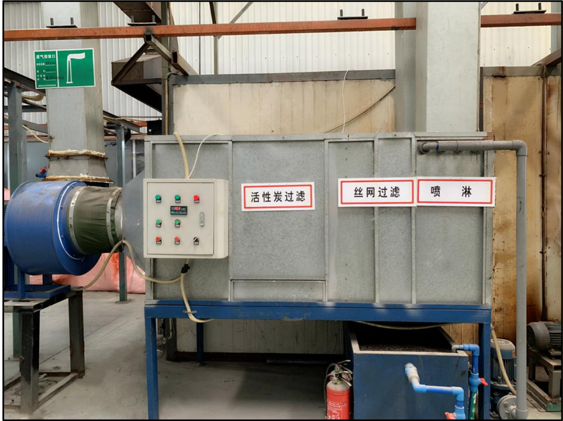
废气处理设施
